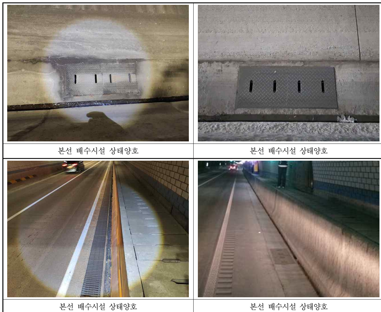
【사진 3.3.16】 배수시설 손상현황
