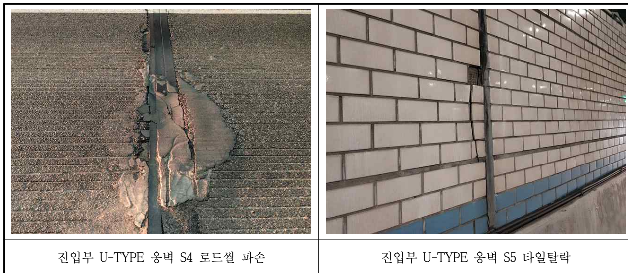
【사진 3.3.42】 U-TYPE 옹벽 손상현황
