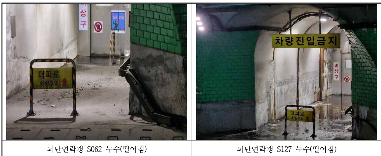
【사진 3.3.38】 피난연락갱 손상현황
